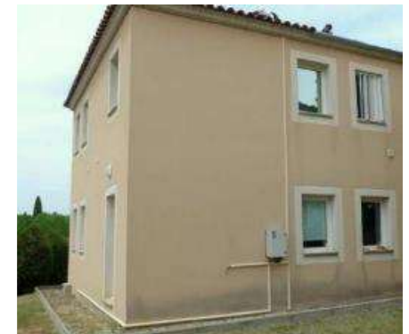
Cheminement des câbles sur les façades Installation de 9 kWc sur une école (84)
