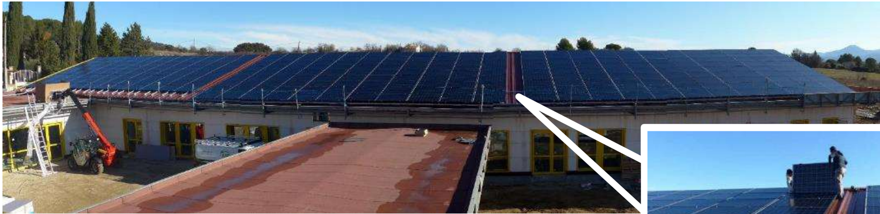
Passage laissé pour les pompiers – Installation de 100 kWc, école (84)
