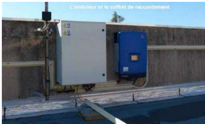
Onduleurs extérieurs au plus près des modules Installation de 9 kWc sur une école (84)
